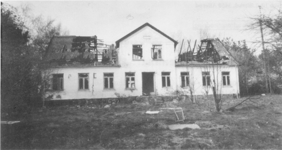
Fortsat fra forsiden: Kærhøjgaards tilbageblevne stuehus udbrændte 4. april 2008, og der er vist ingen grund til at tro på genopbygning; alt er raseret i den ubeboede bygning. Her fotograferet fra havesiden 12. april.
